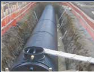
Roma, vasca antincendio
