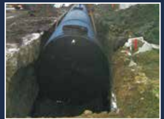
Bando di Argenta (FE), accumulo di prima poggia
